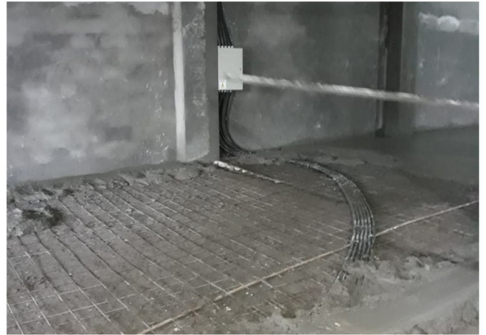
CANALIZACIÓN Y DISTRIBUCIÓN DE CIRCUITOS
