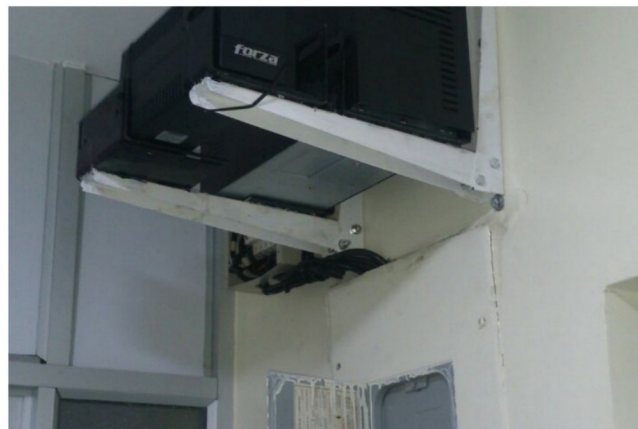
UPS Y RESPALDO ELÉCTRICO
